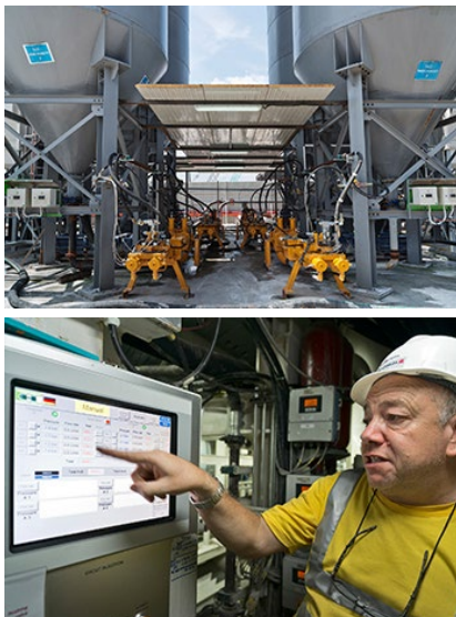
Oben: Die speziell für die Variable-Density-TBM entwickelte dichte Suspension lagert in separaten Bentonittanks.
